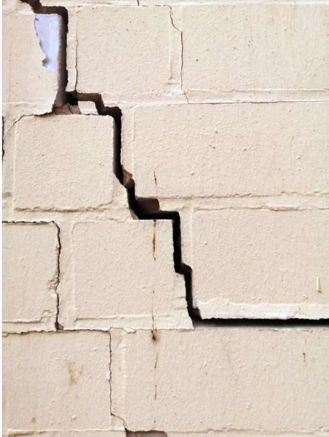
Abbildung 12: Im Mauerwerk befindet sich ein deutlicher tiefgehender Riss.
