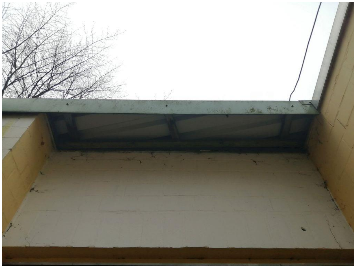
Abbildung 11: Die Attika des Flachdachs weist mehrere Stellen auf, an denen Fledermäuse unter die Verkleidung klettern können.
